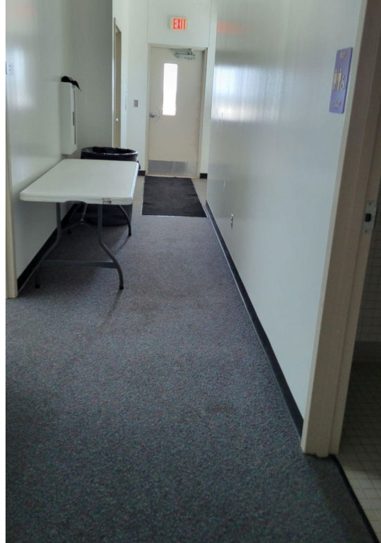
Los espacios son demasiado pequeños para acomodar el tamaño de la escuela; Los acabados están desgastados
